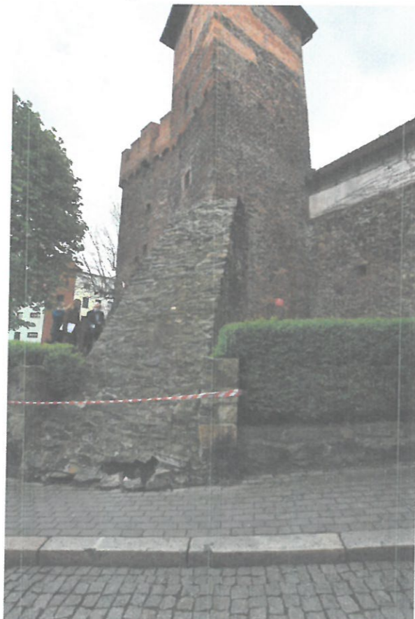
Fot. 1 Widok uszkodzeń u podstawy przypory zachodniej.
