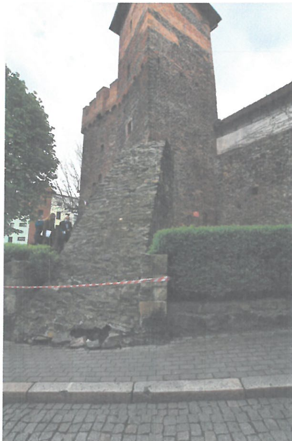
Fot. 1 Widok uszkodzeń u podstawy przypory zachodniej.
