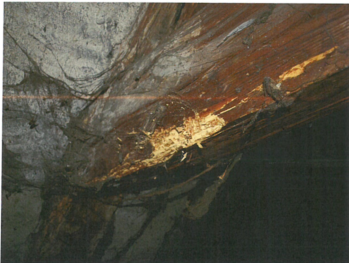
Fot.1 Uszkodzona belka przez Spuszczeła pospolitego ( Hylotrupes baj. )
