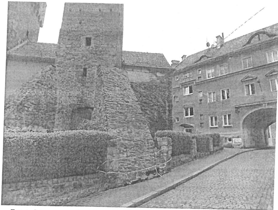
Fot. 1. Przypora zachodnia małej wieży – widoczne uszkodzenia u podstawy
