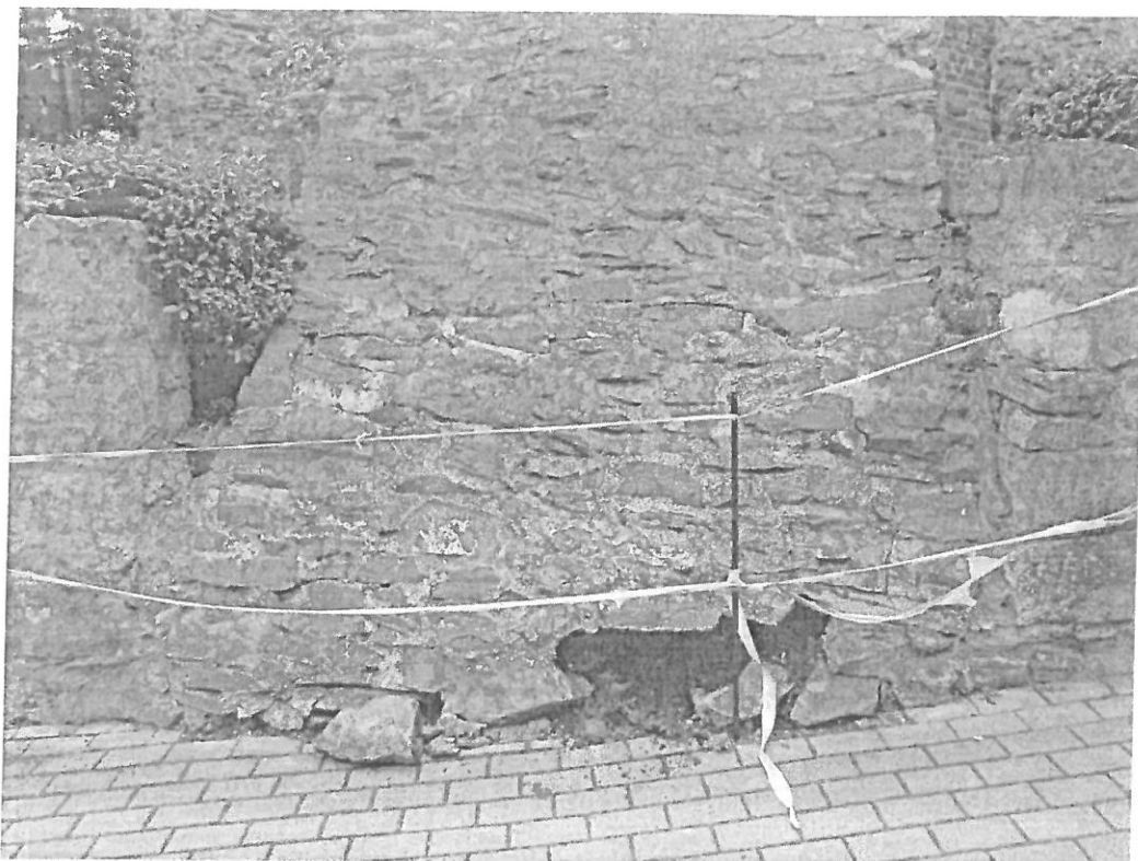
Fot. 2. Uszkodzenia przypory – widoczny brak kamieni pod warstwą zewnętrzną
