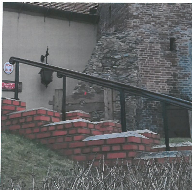
Zdjęcie nr 4. Widok uszkodzonej przypory północnej Małej Wieży
