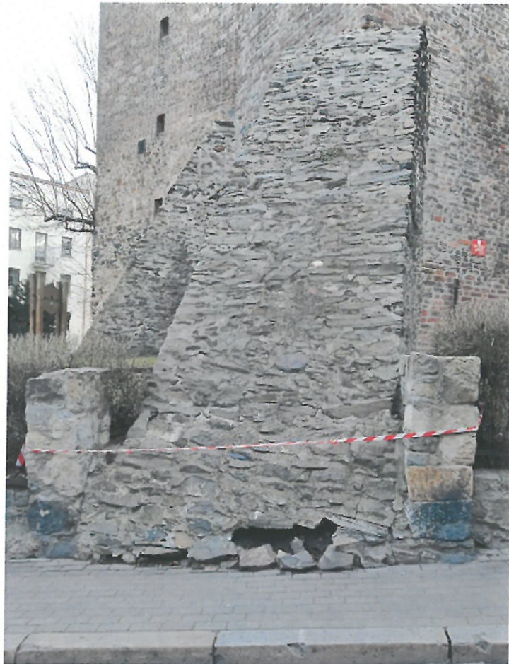
Zdjęcie nr 3. Widok uszkodzonej u podstawy przypory zachodniej Małej Wieży
