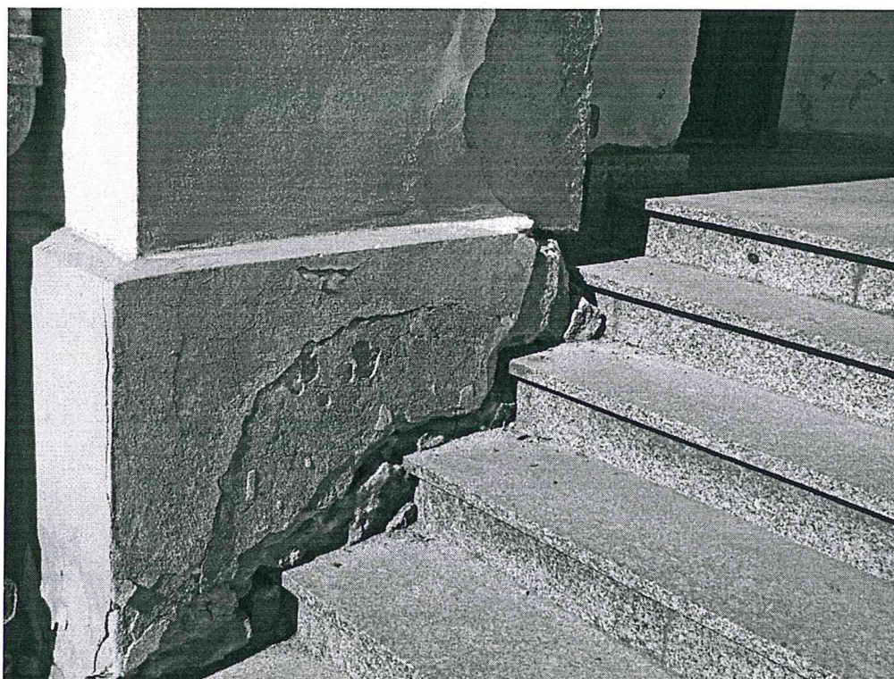
Uszkodzone miejsca przy połączeniu schodów z elewacją.
