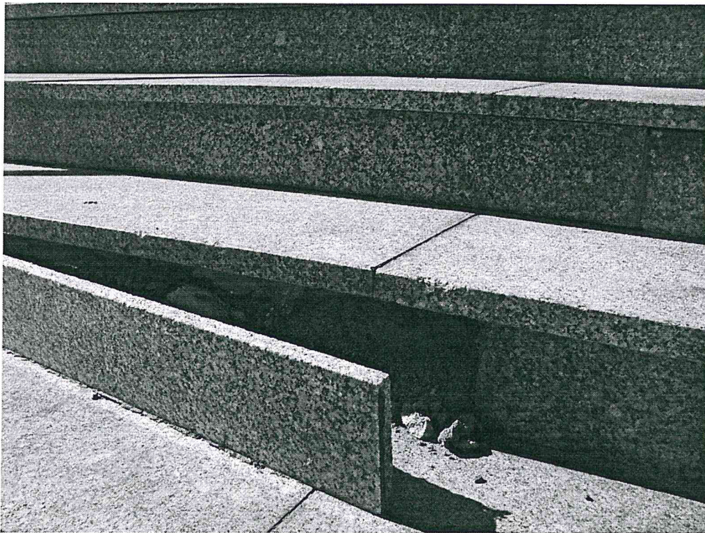
Widok odspojonego policzka schodów.
