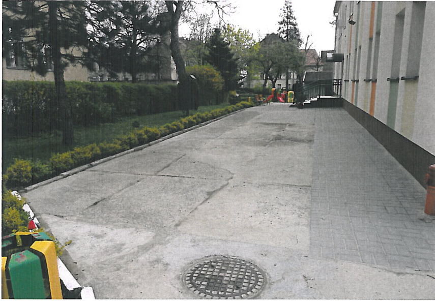
Zdjęcie. 6. Nawierzchnie przeznaczone do remontu
