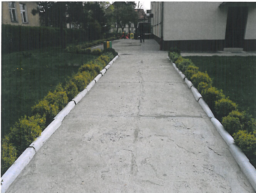
Zdjęcie. 7. Nawierzchnie przeznaczone do remontu
