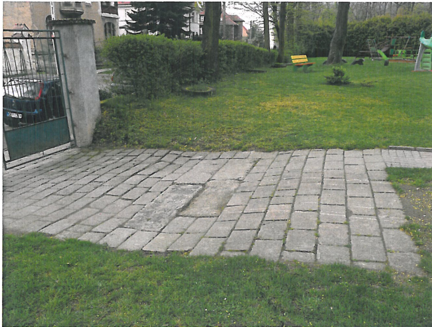
Zdjęcie. 4. Nawierzchnie przeznaczone do remontu
